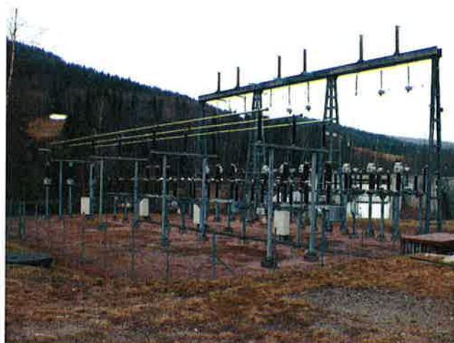
Figur 7-32 Bildet viser et typisk koblingsanlegg av typen som er tenkt etablert ved Øyan. (Foto: Skagerak Kraft )
